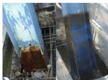
図 15 スtrandシートによる 橋梁鉄鋼部材の補修例 (左：補修前、右：補修後)
